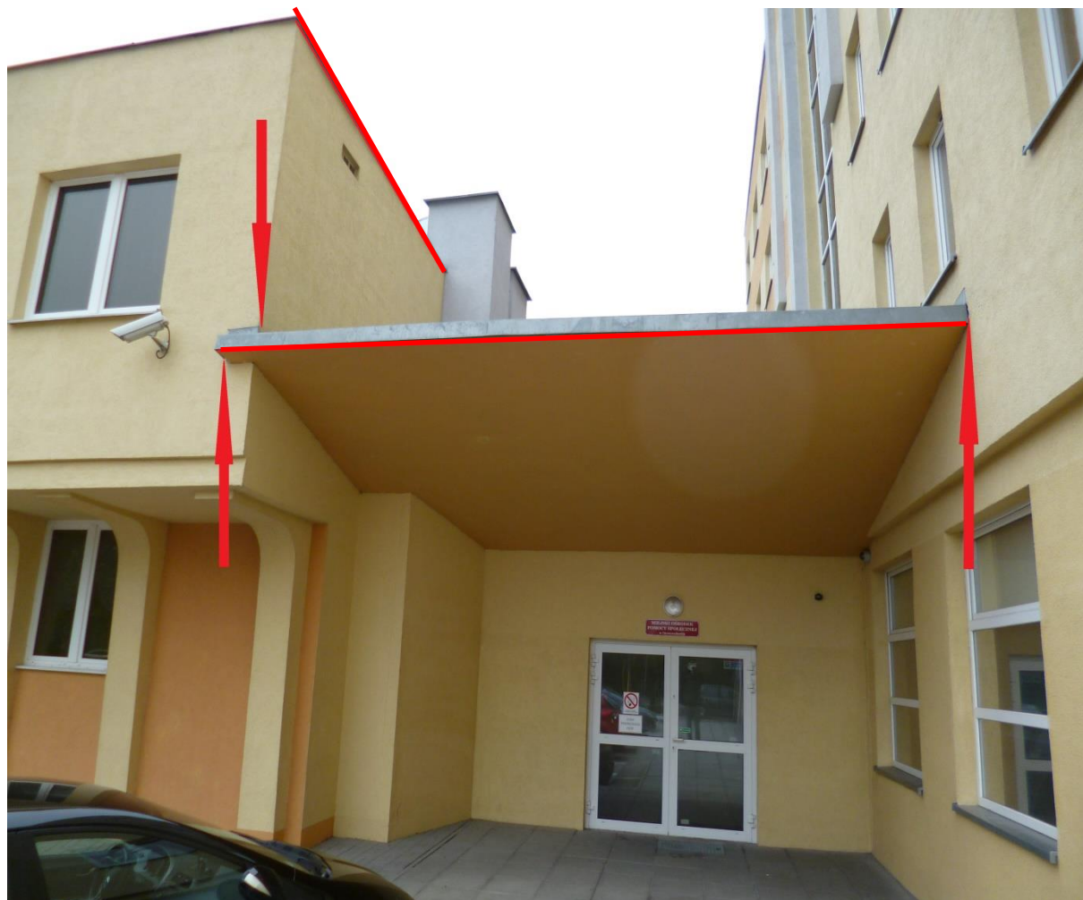
Fot. 1 Lokalizacja miejsc lęgowych wróbla Passer domesticus (czerwone strzałki) oraz ubytki i szczeliny w elewacji pod opierzeniem dachu mogące stanowić potencjalne siedliska lęgowe ptaków (czerwone linie).
