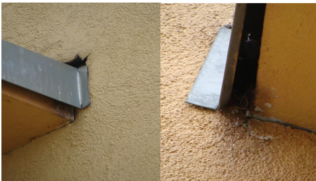
Fot. 9 Szczeliny w elewacji pomiędzy łącznikiem a budynkiem Środowiskowego Domu Samopomocy i budynku Miejskiego Ośrodka Pomocy Społecznej – miejsca lęgowe wróbla
