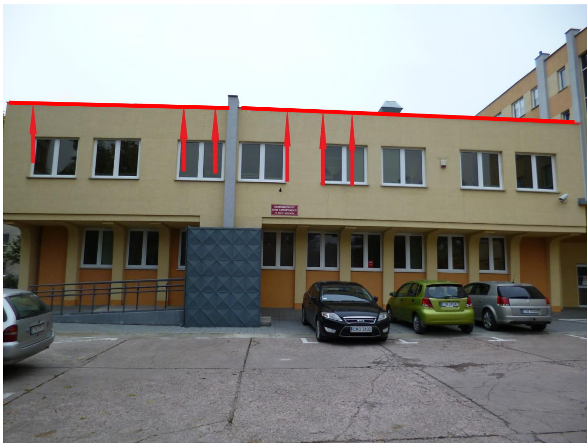
Fot. 2 Lokalizacja miejsc lęgowych wróbla Passer domesticus (czerwone strzałki) oraz ubytki i szczeliny w elewacji pod opierzeniem dachu mogące stanowić potencjalne siedliska lęgowe ptaków (czerwone linie).
