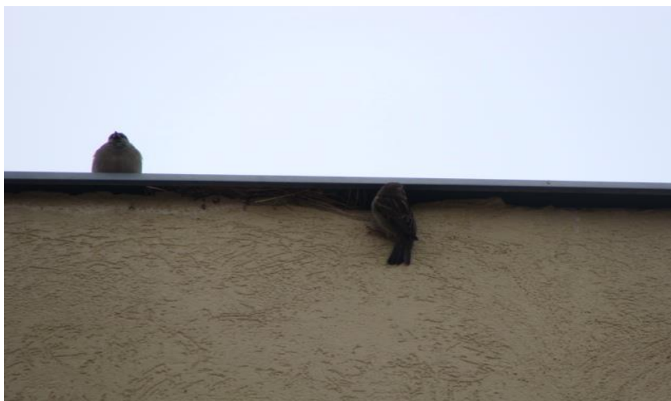
Fot. 3 Para wróbli Passer domesticus przy gnieździe – ubytki w elewacji pod opierzeniem dachu.
