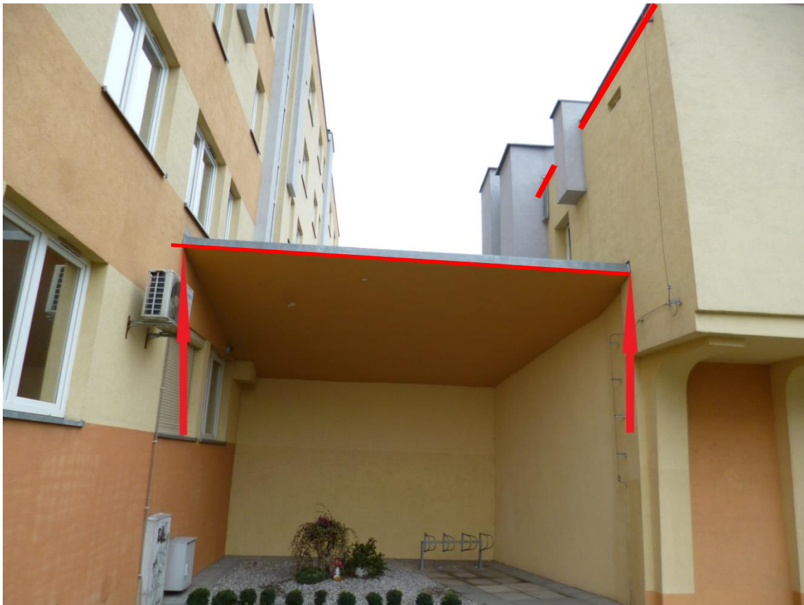
Fot. 8 Lokalizacja miejsc lęgowych wróbla Passer domesticus (czerwone strzałki) oraz ubytki i szczeliny w elewacji pod opierzeniem dachu mogące stanowić potencjalne siedliska lęgowe ptaków (czerwone linie).
