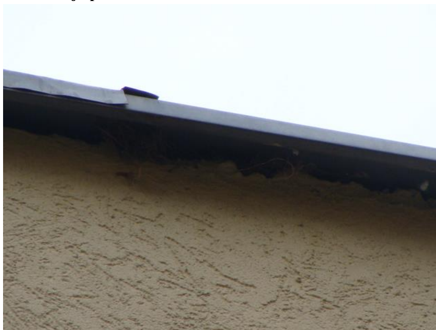
Fot. 5 Materiał gniazdowy widoczny w szczelinie pod opierzeniem dachu
