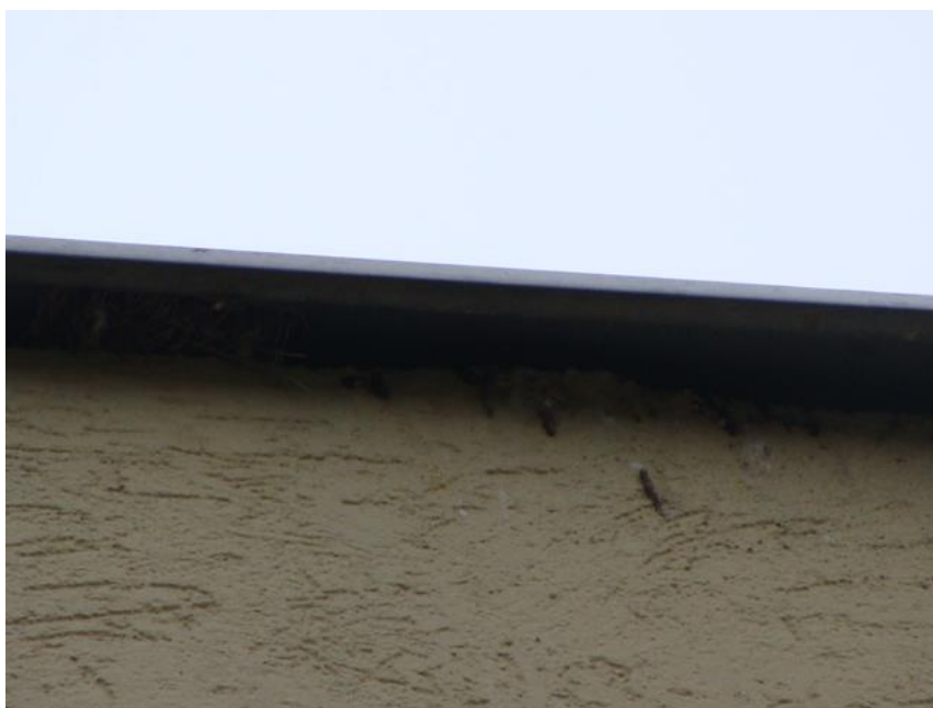
Fot. 7 Materiał gniazdowy widoczny w szczelinie pod opierzeniem dachu oraz świeże odchody świadczące o aktualnym wykorzystywaniu miejsca przez ptaki.
