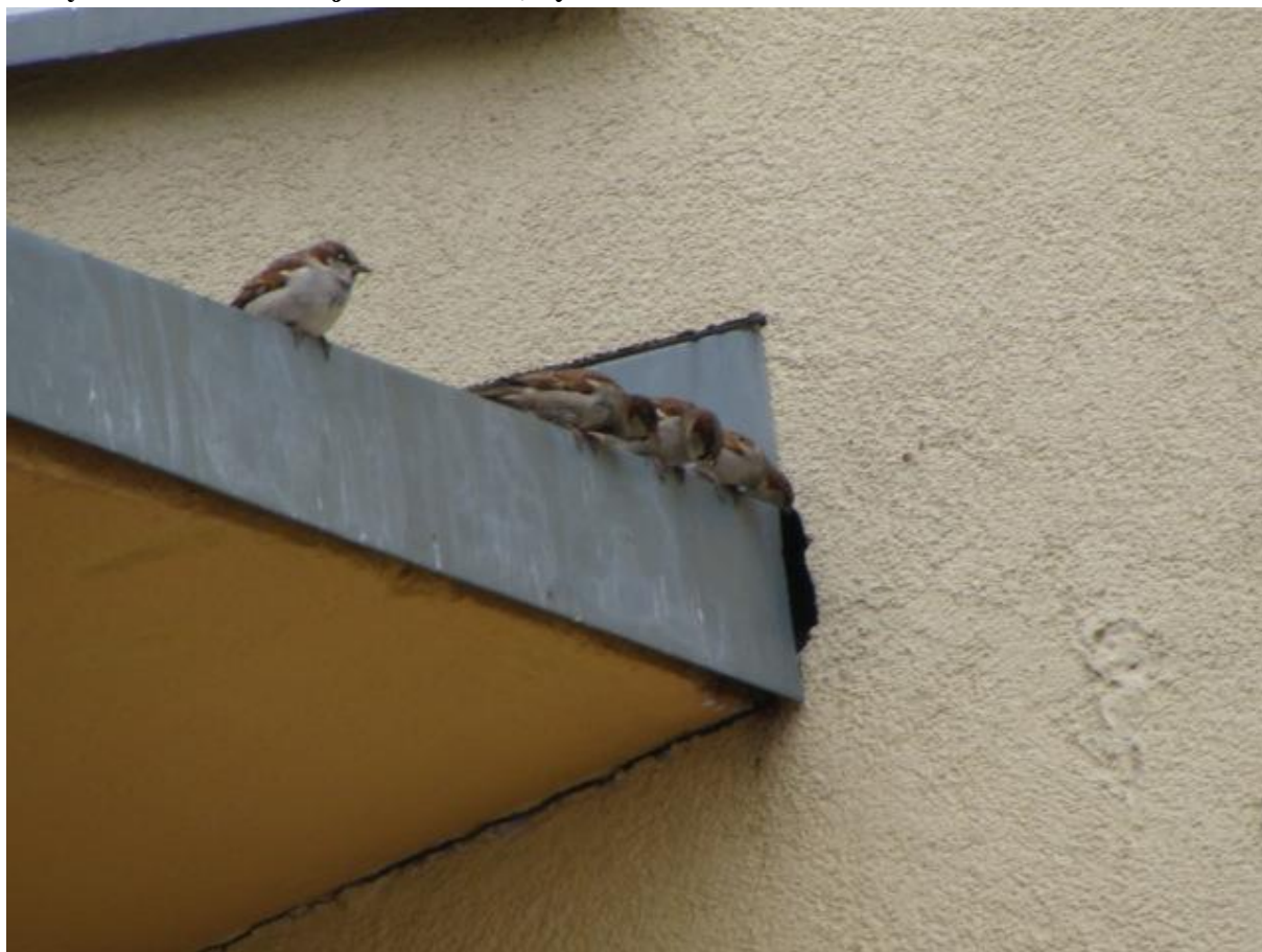
Fot. 10 Stado wróbla Passer domesticus przy szczelinie w elewacji pomiędzy łącznikiem ŚDS a budynkiem MOPS.
