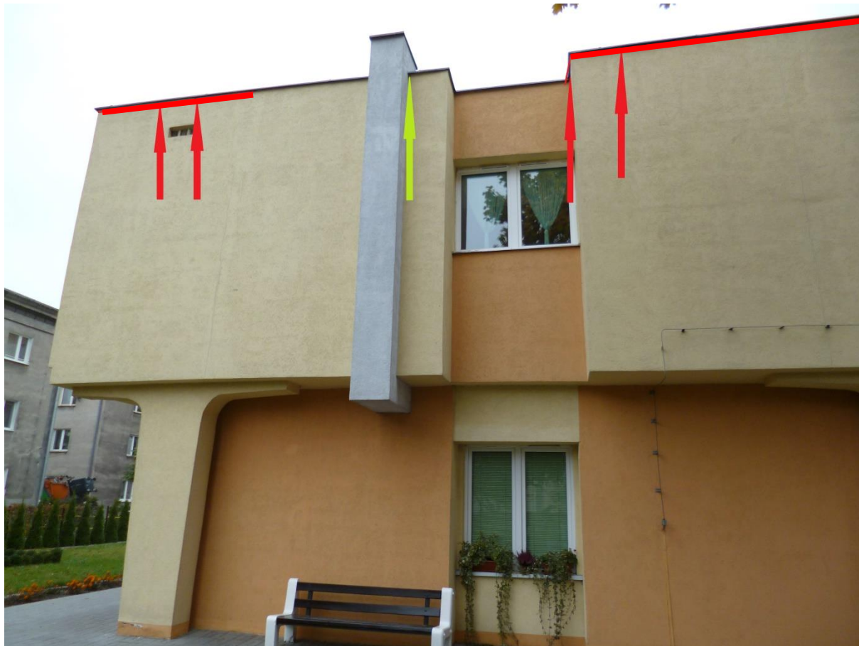
Fot. 4 Lokalizacja miejsc lęgowych wróbla Passer domesticus (czerwone strzałki), prawdopodobne miejsce lęgowe kopciuszka Phoenicurus ochruros (zielona strzałka) oraz ubytki i szczeliny w elewacji pod opierzeniem dachu mogące stanowić potencjalne siedliska lęgowe ptaków (czerwone linie).
