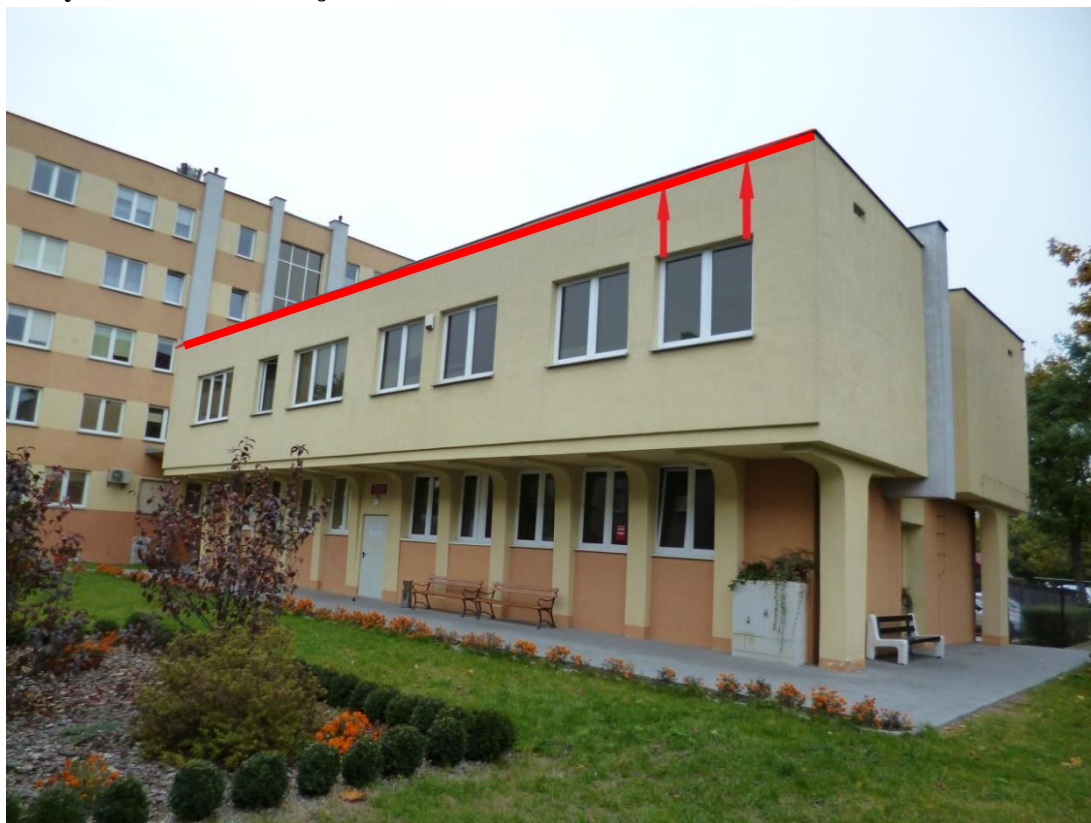
Fot. 6 Lokalizacja miejsc lęgowych wróbla Passer domesticus (czerwone strzałki) oraz ubytki i szczeliny w elewacji pod opierzeniem dachu mogące stanowić potencjalne siedliska lęgowe ptaków (czerwone linie).
