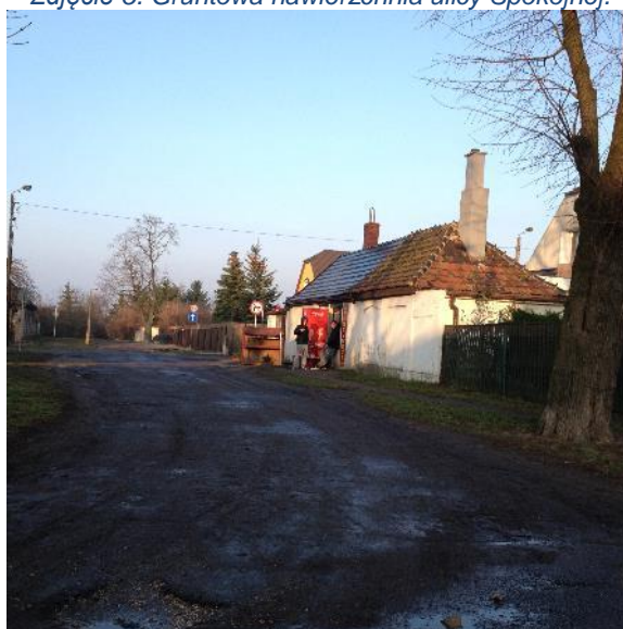
Zdjęcie 5. Gruntowa nawierzchnia ulicy Spokojnej.
