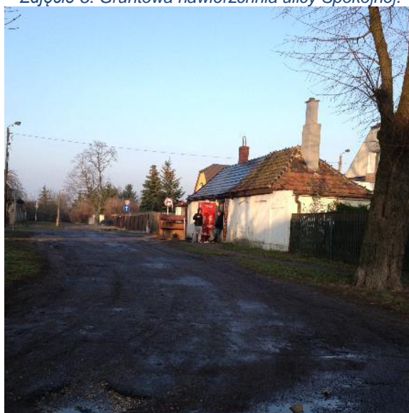
Zdjęcie 5. Gruntowa nawierzchnia ulicy Spokojnej.
