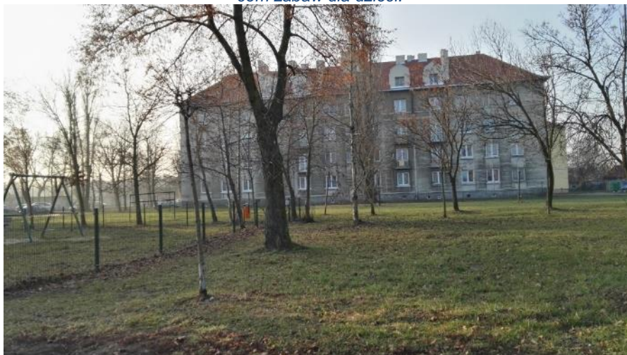
Zdjęcie 4. Budynek mieszkalny wielorodzinny z 1954 r. przy ulicy Pięknej 19 wraz z terenem zieleni i zaniedbanym placem zabaw dla dzieci.
