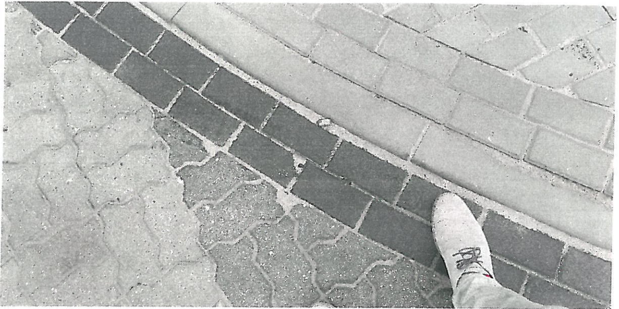
7. Wystający beton przy znaku drogowym do poprawy
