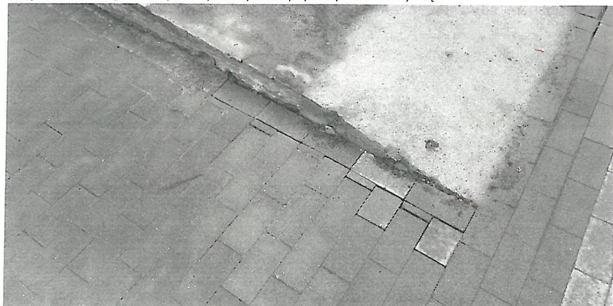
15. Podjazd betonowy dla niepełnosprawnych do poprawy – rozkruszył się
