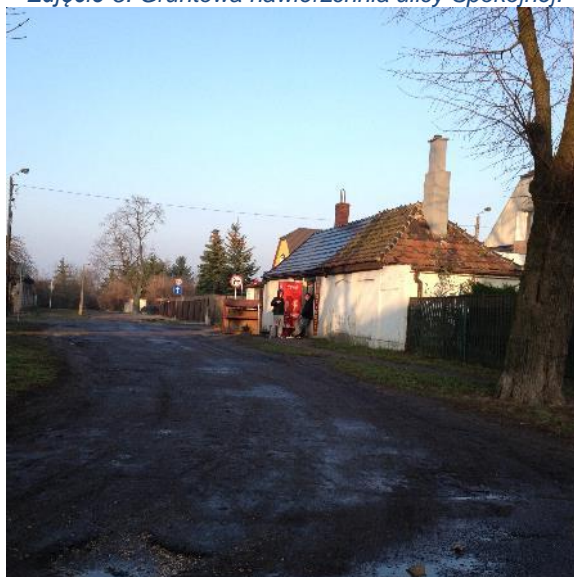
Zdjęcie 5. Gruntowa nawierzchnia ulicy Spokojnej.
