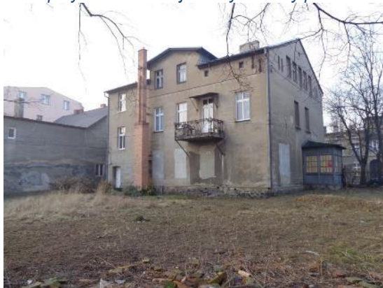
Zdjęcie 1. Budynek z 1880 roku przy ul. Toruńskiej 24 użytkowany przez Towarzystwo Brata Św. Alberta
