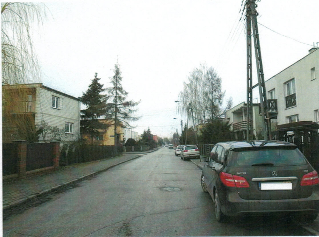
Fot. 1 Pikietaż 0+020. Nawierzchnia z masy bitumicznej. Widoczne ubytki powierzchniowe, zapadnięcia oraz spękania. Występuje obustronny chodnik z kostki betonowej.
