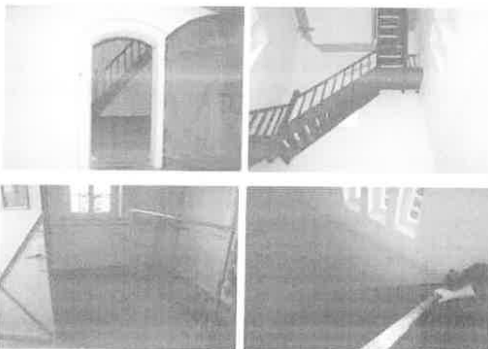
Fot.36 Budynek UM Inowrocław – Ratusz – Poddasze nieużytkowe skrzydła A1 – wejście do nieużytkowanej windy (wykonał: kpt. Jarosław Skotnicki)
