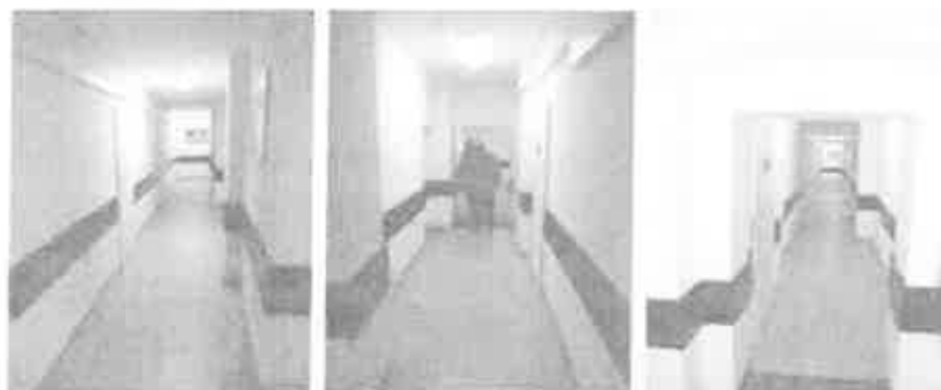
Fot.24 Budynek UM Inowrocław – Ratusz – Poziomy odcinek dojścia ewakuacyjnego nr 2 na III kondygnacji nadziemnej w skrzydle A2 do wejścia do klatki K1 (wykonał: kpt. Jarosław Skotnicki)
