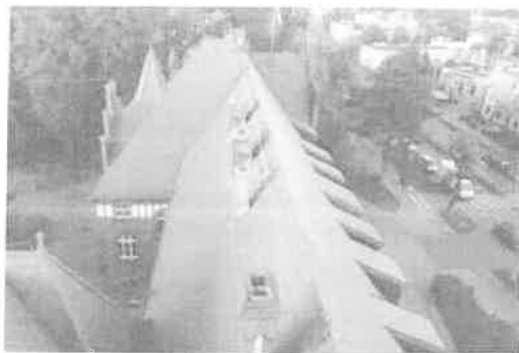
Fot.12 Budynek UM Inowrocław – Ratusz – dach skrzydła A1 (wykonanie: kpt. Jarosław Skotnicki)
