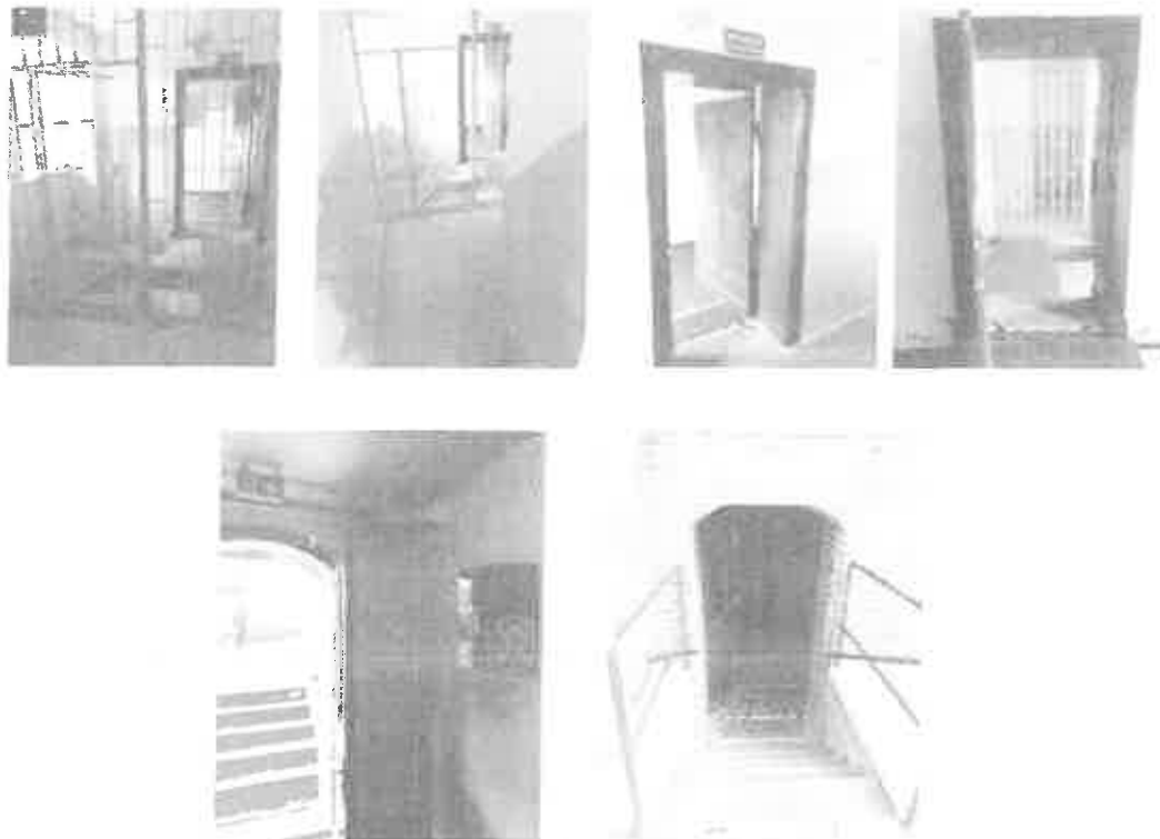
Fot.23 Budynek UM Inowrocław – Ratusz – Pionowy odcinek dojścia ewakuacyjnego nr 1 z III kondygnacji klatką K2 w skrzydle A1 do wyjścia W2 (wykonał: kpt. Jarosław Skotnicki)
