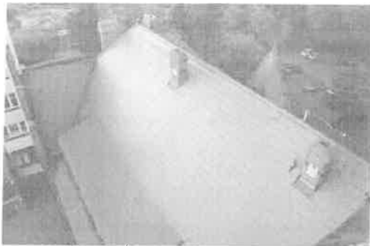
Fot.11 Budynek UM Inowrocław – Ratusz – dach skrzydła A; (wykonanie: kpt. Jarosław Skotnicki)
